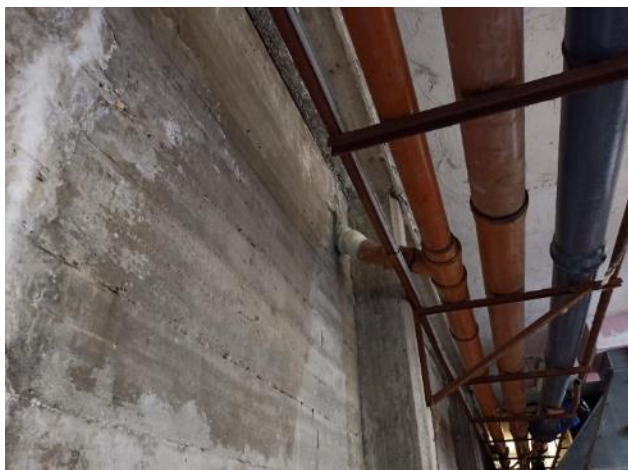
Foto 21 – perdite dalla vasca
