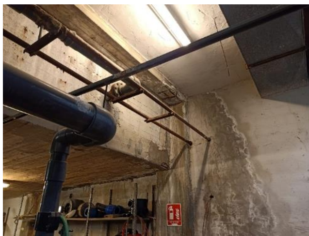
Foto 24 – perdite diffuse dalla vasca
