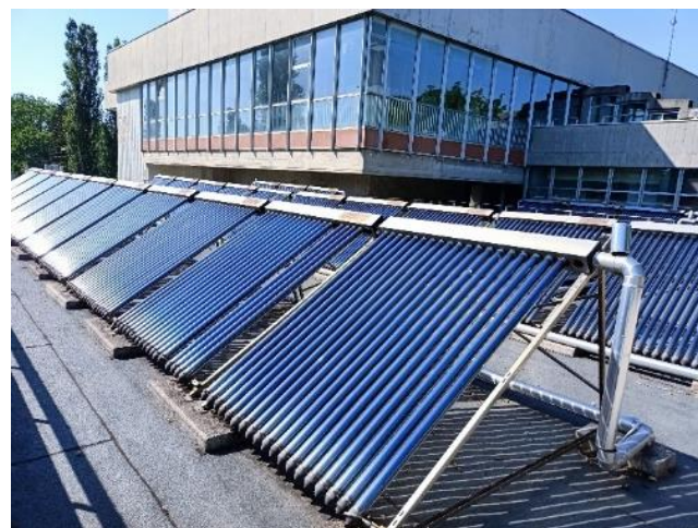
Foto 4 – collettori solari termici
