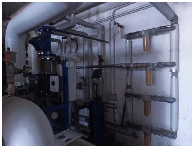
Foto 6 – batteria di filtri per acqua in ingresso
