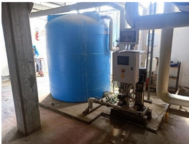
Foto 5 – accumulo preautoclave e pompaggio
