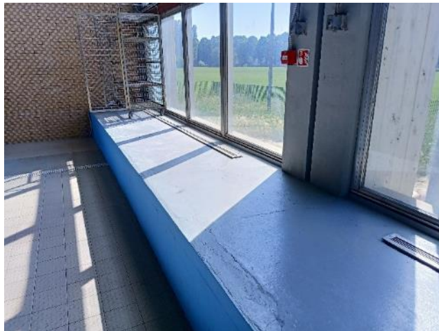
Foto 30 – plenum di mandata sotto finestre
