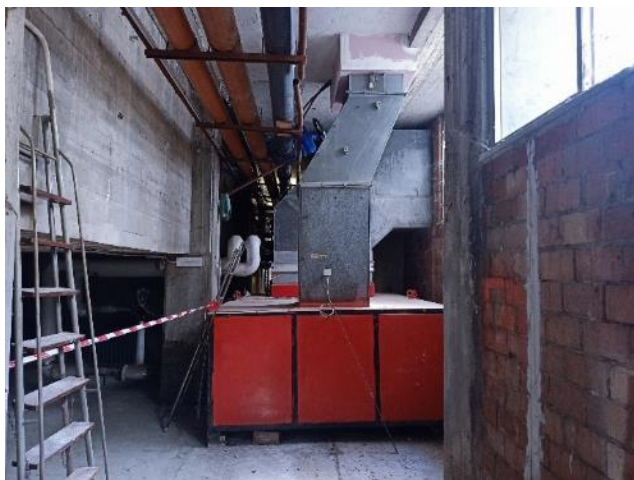
Foto 29 – centrale di trattamento condensa finestre
