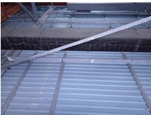
Foto 34 – canalizzazioni mandata sottotetto
